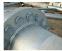
压力管道 Pressure piping
